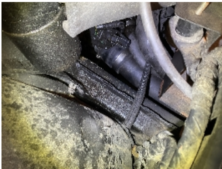
40. Utvendig tilstand motor
