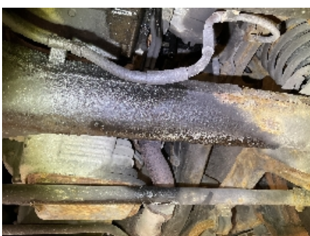
58. Utvendig tilstand motor
